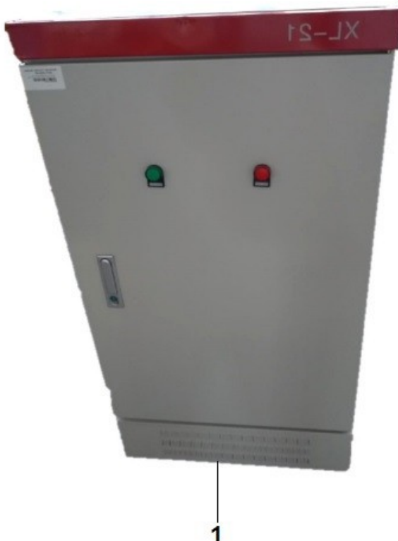
QUADRO TRANSFERÊNCIA AUTOMÁTICA QUADRO TRANSFERENCIA AUTOMÁTICA FRAME AUTOMATIC TRANSFER
